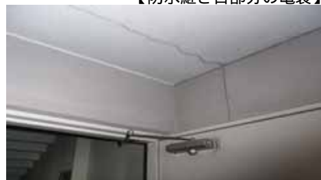
【渡り廊下部分のクラック】
