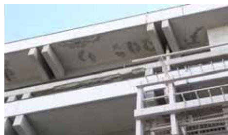
【軒裏・手摺部分の鉄筋露出】
