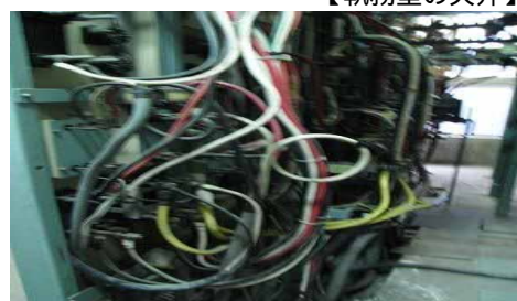
【電気室の配線】
