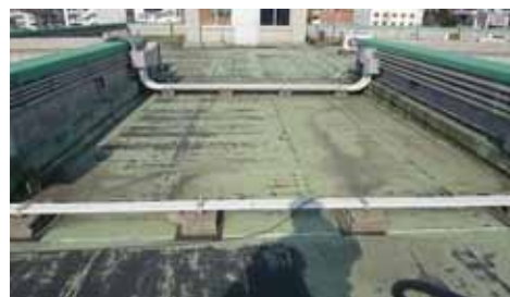
【防水継ぎ目部分の亀裂】
