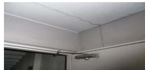
【渡り廊下部分のクラック】
