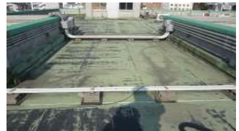
【防水継ぎ目部分の亀裂】
