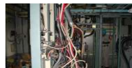
【電気室の配線】
