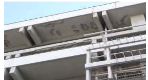
【軒裏・手摺部分の鉄筋露出】
