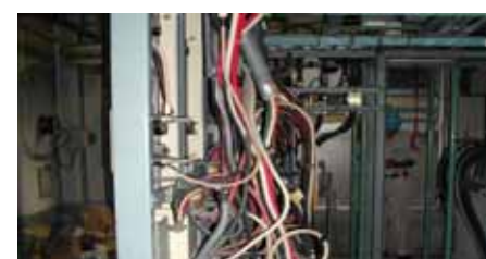
【電気室の配線】
