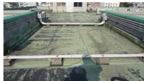
【防水継ぎ目部分の亀裂】
