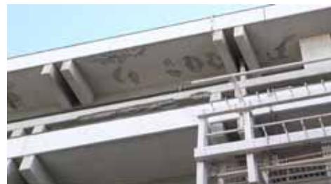
【軒裏・手摺部分の鉄筋露出】
