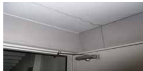
【渡り廊下部分のクラック】
