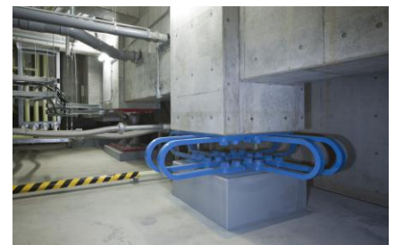
【事例：刈谷市 免震装置】
