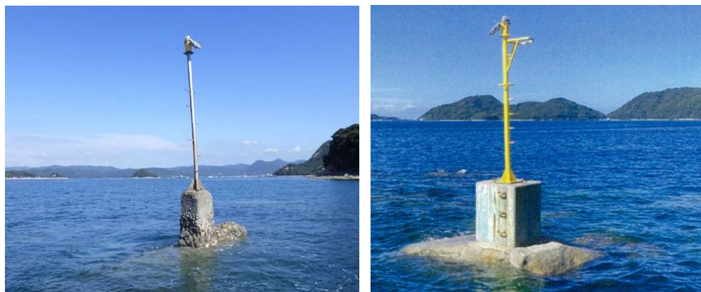
写真3-4 航路標識灯の支柱取替（変形した支柱を安全配慮した支柱に交換）
