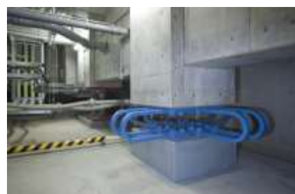
【事例：刈谷市 免震装置】
