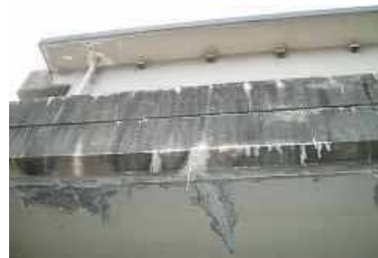
外壁のコンクリートが老朽
