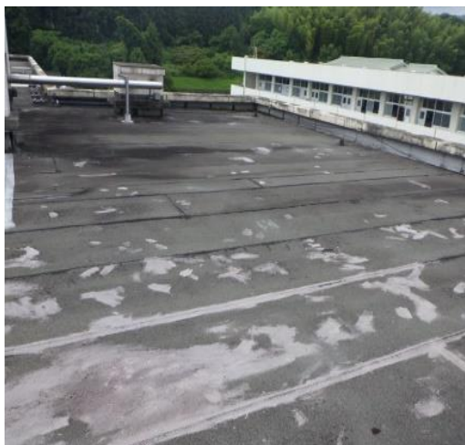
防水層の劣化
