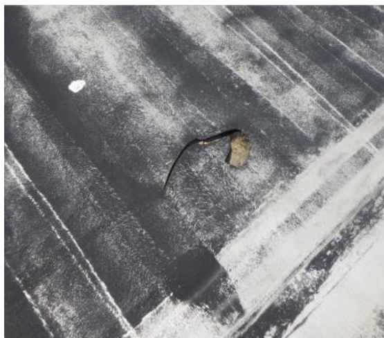
防水層の破断
