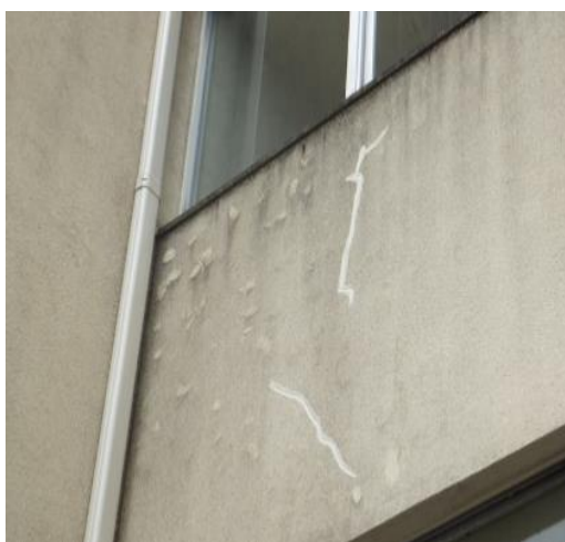
外壁塗装の劣化
