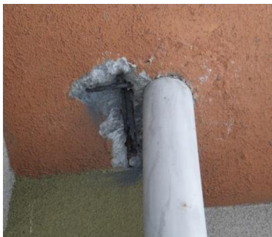
軒裏の露出鉄筋、剥落
