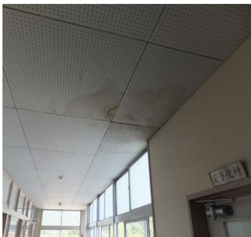
内部仕上げの雨漏り
