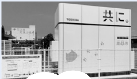
100kW純水素燃料電池の設置 (商品機第1号、第2号)
