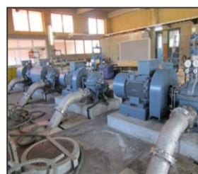
浄水池・送水ポンプ
