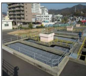
高速凝集沈澱池
