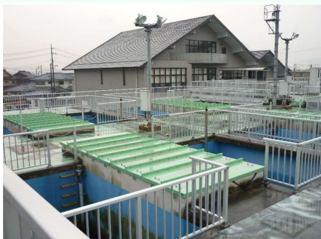
楠本浄水場 急速ろ過池
