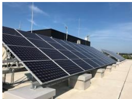
【市役所本庁舎の太陽光発電設備】
