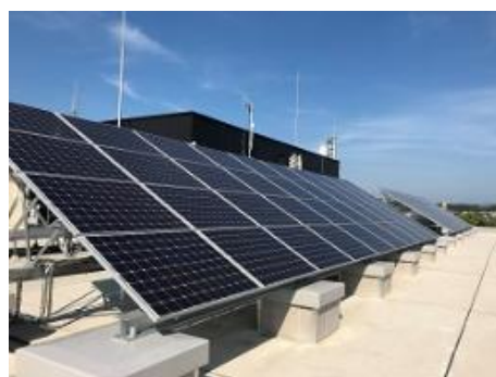
【市役所本庁舎の太陽光発電設備】
