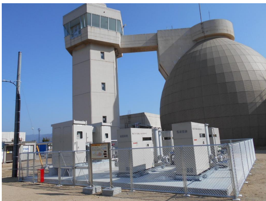
徳山東部浄化センターの消化ガス発電設備
