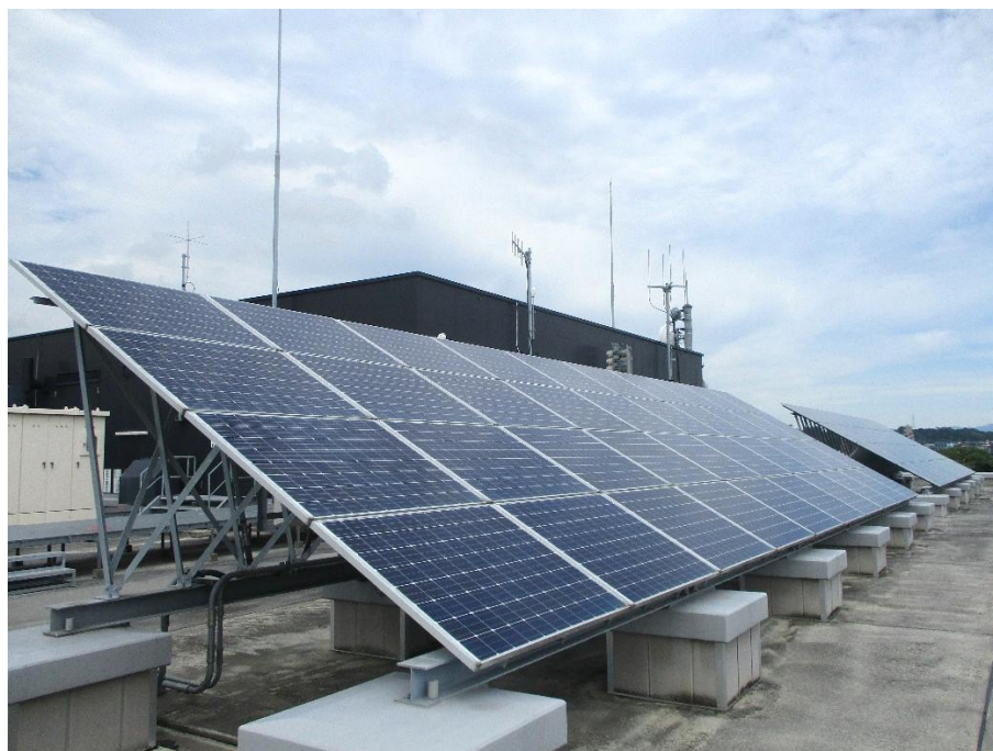
市役所本庁舎の太陽光発電設備
