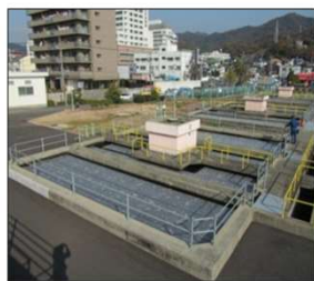
高速凝集沈澱池
