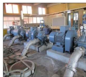
浄水池・送水ポンプ
