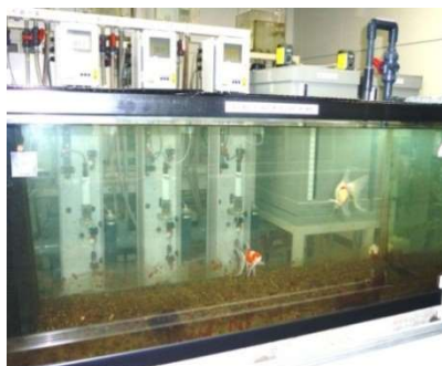
魚類監視装置（原水用）
