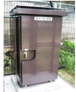
水質自動監視装置 (市内8箇所)
