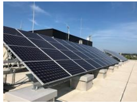
【市役所本庁舎の太陽光発電設備】
