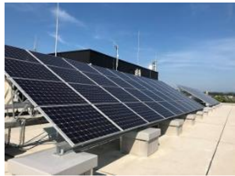
【市役所本庁舎の太陽光発電設備】
