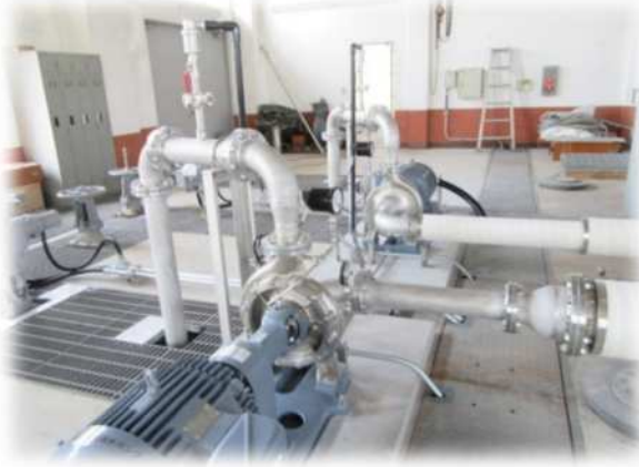
[送水設備(高地区用ポンプ)]
