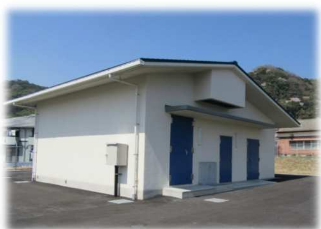
〔北山加圧ポンプ所〕
