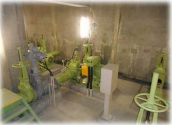
〔送水設備 (送水ポンプ)〕
