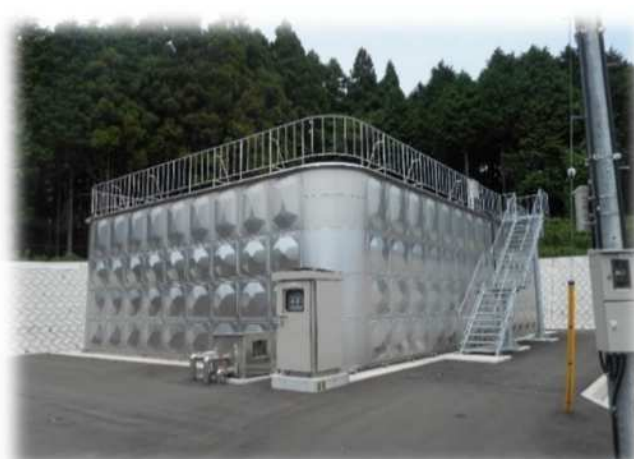
〔太刀野配水池、太刀野加圧ポンプ〕
