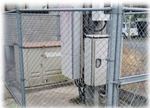
[次亜注入設備（大向）]
