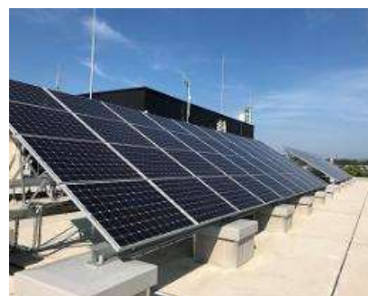
【市役所本庁舎の太陽光発電設備】
