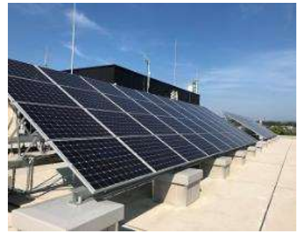
【市役所本庁舎の太陽光発電設備】
