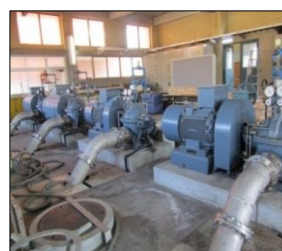
浄水池・送水ポンプ
