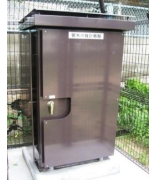
水質自動監視装置 (市内8箇所)
