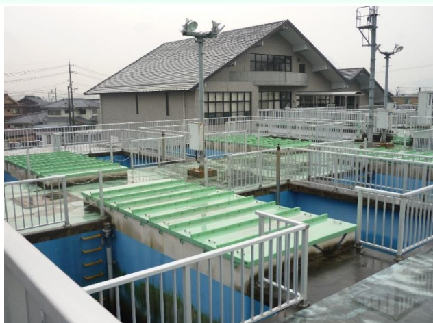
楠本浄水場 急速ろ過池
