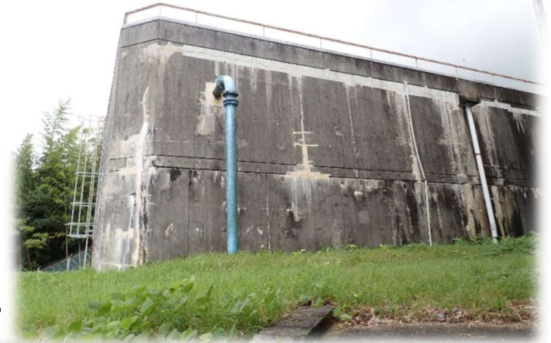
こうちくはいすいち 高地区配水池
