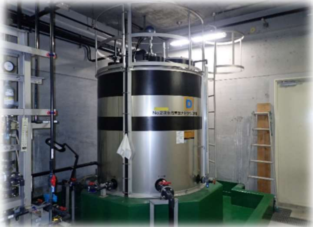
じあえんそさん 次亜塩素酸ナトリウム注入設備
