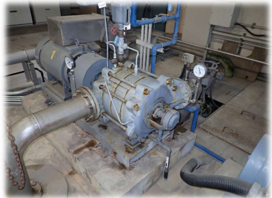
とうぶこうちくそうすい 東部高地区送水ポンプ
