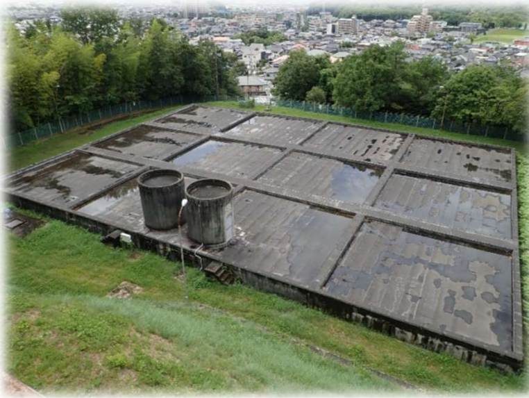
ていちくはいすいち 低地区配水池
