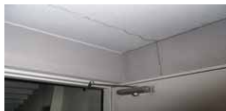
【渡り廊下部分のクラック】
