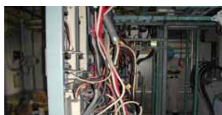
【電気室の配線】
