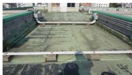
【防水継ぎ目部分の亀裂】
