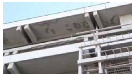
【軒裏・手摺部分の鉄筋露出】
