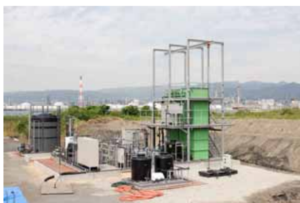
【東部浄化センターに設置された試験装置】
