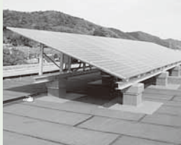
※富田東小に設置された太陽光発電施設
