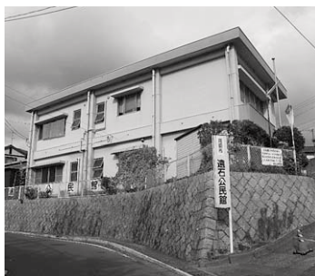
老朽化した遠石公民館
