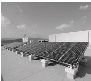
太陽光発電設備が設置されたリサイクルプラザ「ペガサス」
