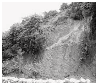
昨年7月の豪雨により崩落した斜面(上迫町)
