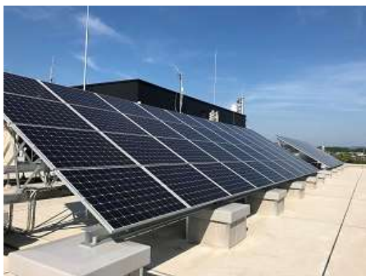
【市役所本庁舎の太陽光発電設備】
