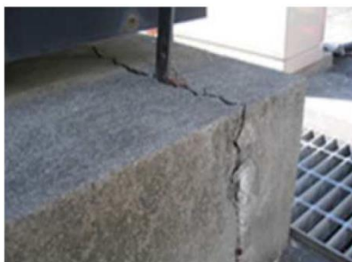
看板基礎のひび割れ
