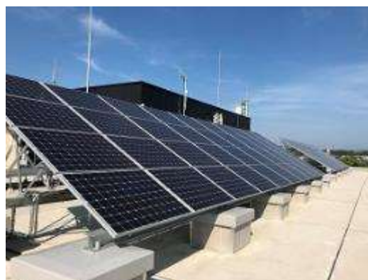
【市役所本庁舎の太陽光発電設備】
