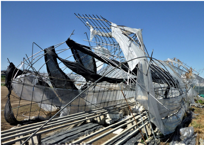
台風被害の様子
