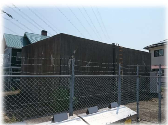
[秋月団地低地区配水池]
