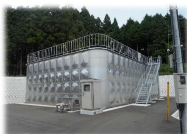
〔太刀野配水池、太刀野加圧ポンプ〕
