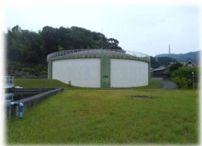
〔一の井手低地区配水池〕
