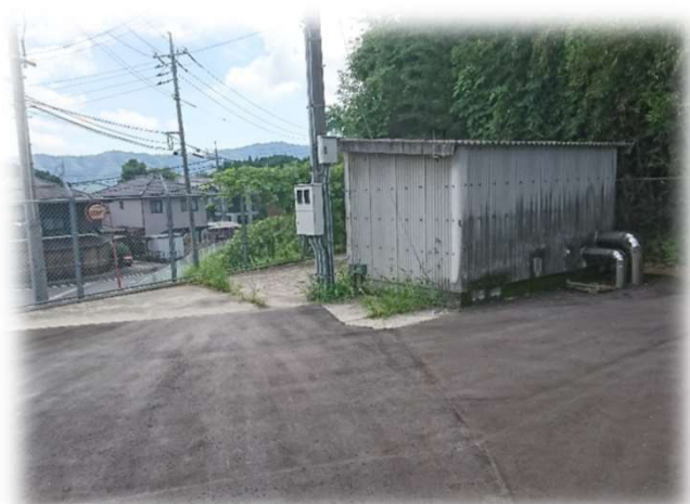
〔勝間ヶ丘加圧ポンプ所〕
