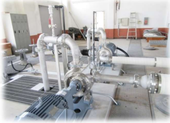
[送水設備(高地区用ポンプ)]
