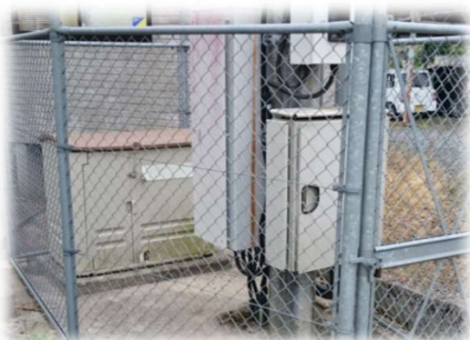
[次亜注入設備（大向）]
