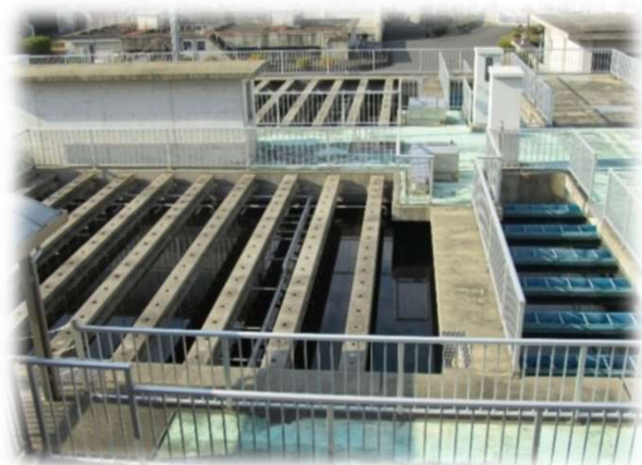
〔傾斜板式沈澱池〕
