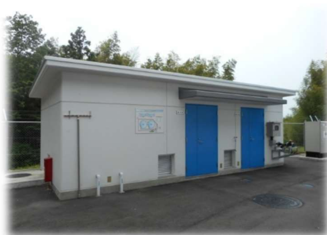
〔次垂注入室（樋口配水場内）〕
