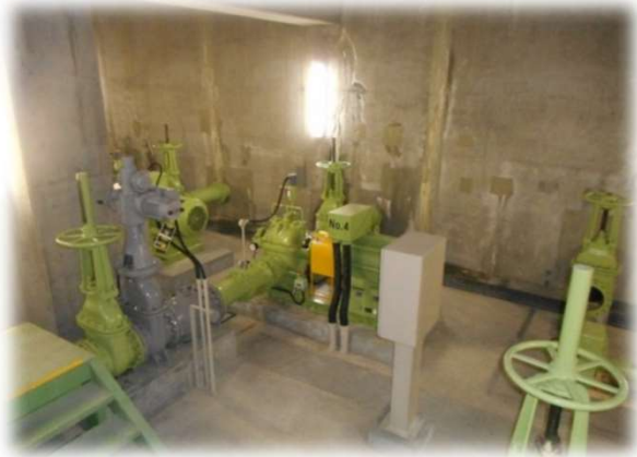
〔送水設備（送水ポンプ）〕
