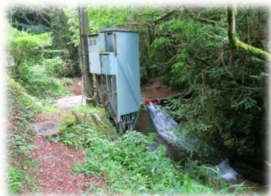
[取水場 (戸石川表流水)]
