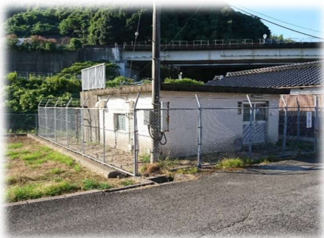
〔戸田山加圧ポンプ所〕
