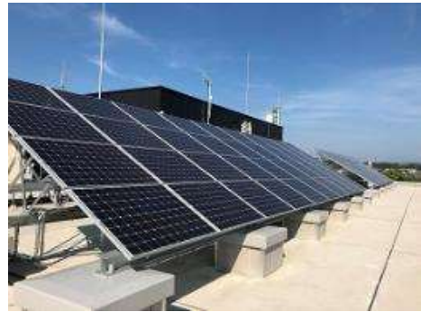
【市役所本庁舎の太陽光発電設備】
