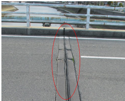
写真2-5 伸縮装置の損傷
