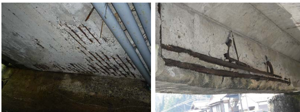
写真2-2 RC床版橋とRC桁橋の剥離・鉄筋露出 ※補修済
