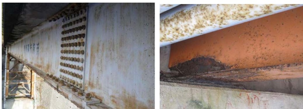
写真2-3 鋼桁の防食機能の劣化と桁端部の孔食 ※補修済
