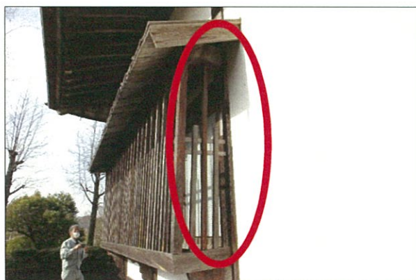
前傾し、部材の接合部分にすき間ができている
