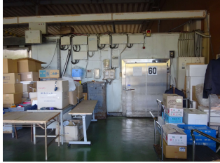
大豆製品保管冷蔵庫
