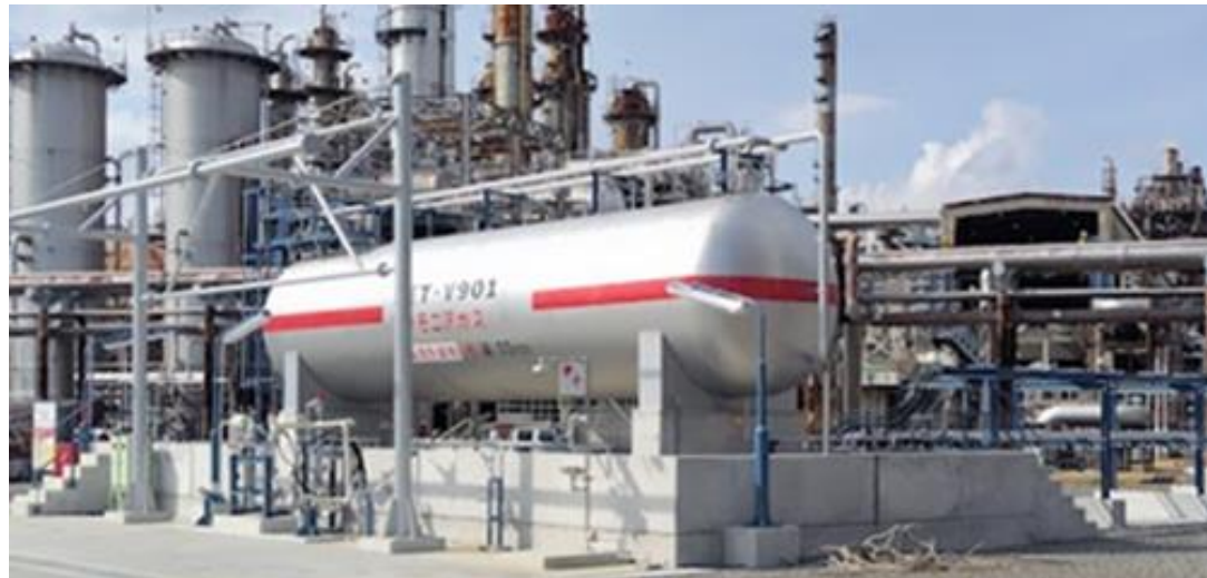
燃焼用アンモニアタンク
