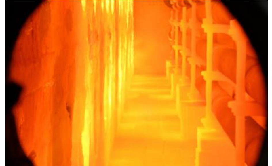
アンモニア燃焼時の様子 (左側の明るい部分がアンモニア燃焼部)
